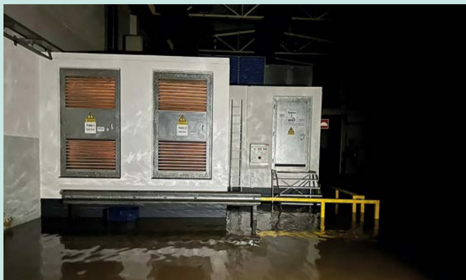
Überflutete Netzstation in der Bahnhofstraße
