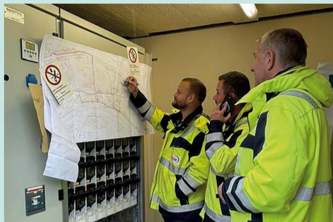
Die Trafostation Mozartstraße als mobile Einsatzzentrale
